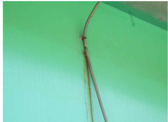
배수시설 유도배수관 누수(S1)
