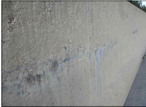
방호벽 균열부 백태(S1)
