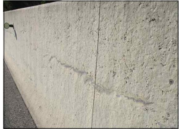
방호벽 균열부 백태(S3)
