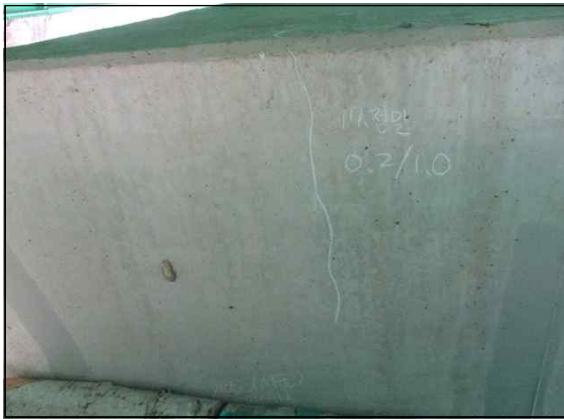
교각 코핑부 균열(P1)
