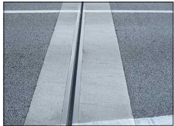
신축이음 후타재 균열(A1)
